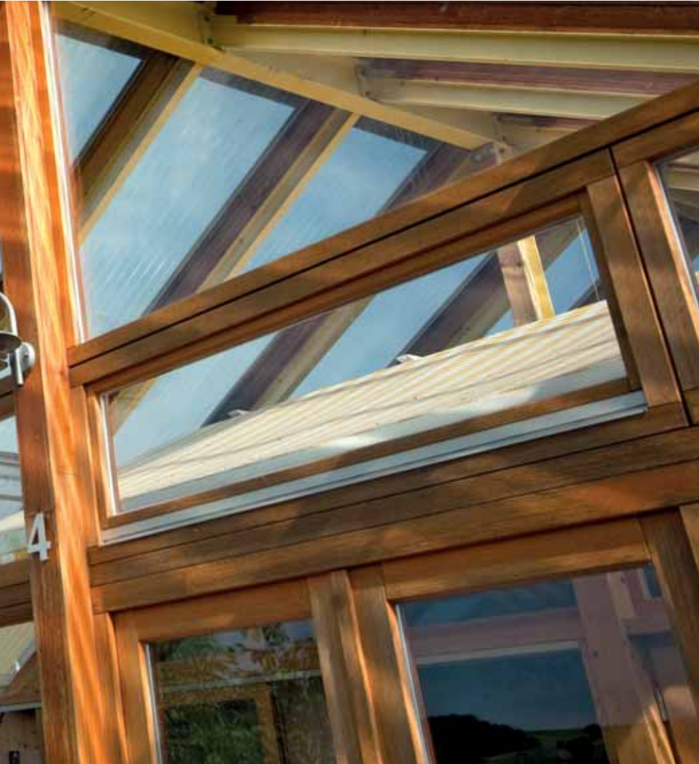
D'estate, l'aria calda esce da aperture a vasistas nel tetto. Così all'interno della casa la temperatura rimane fresca.
